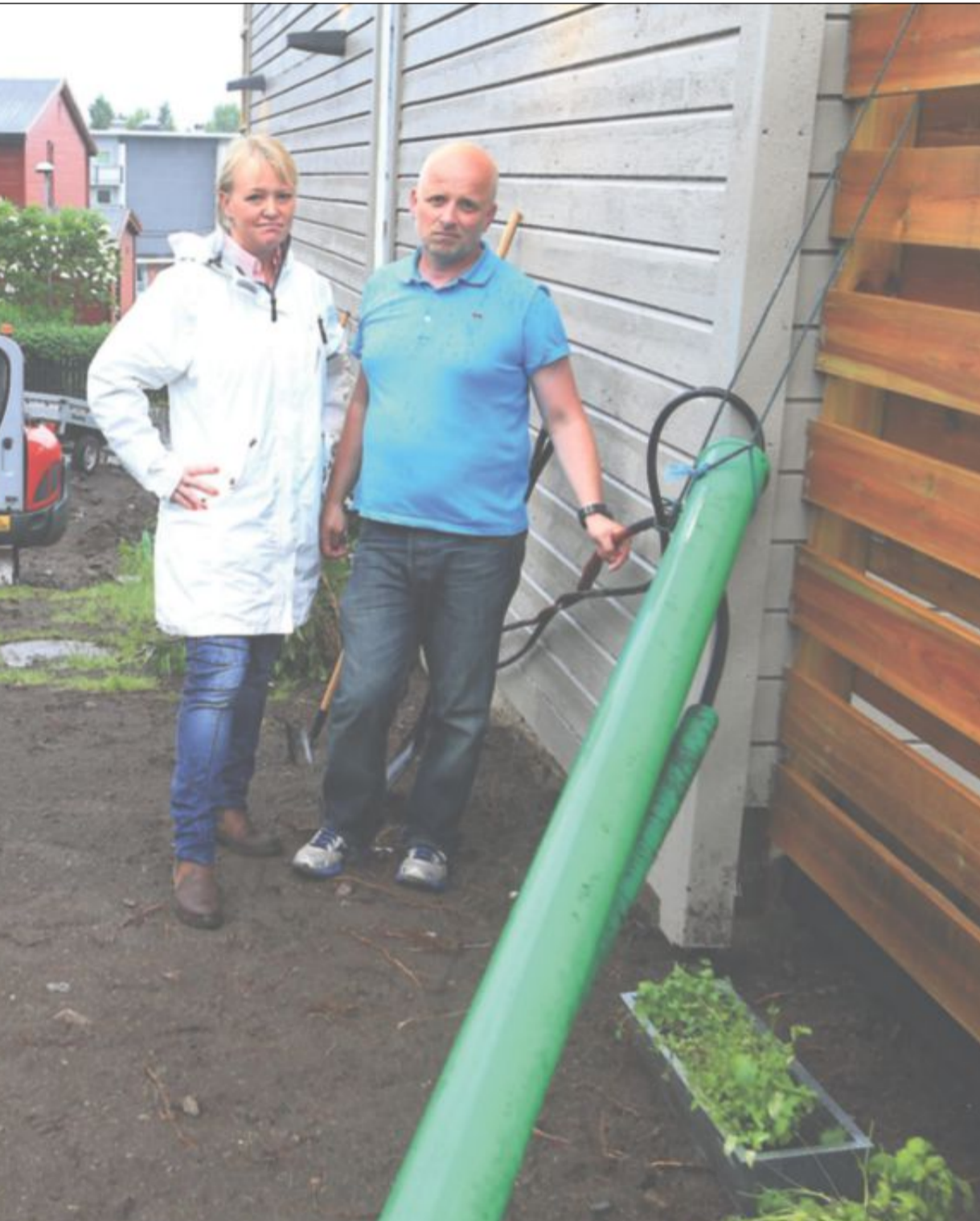
nivået for gressplenen ble senket grunnet råteskader på veggene kommer den tydelig frem. Sophy og Lasse er fortvilet over
